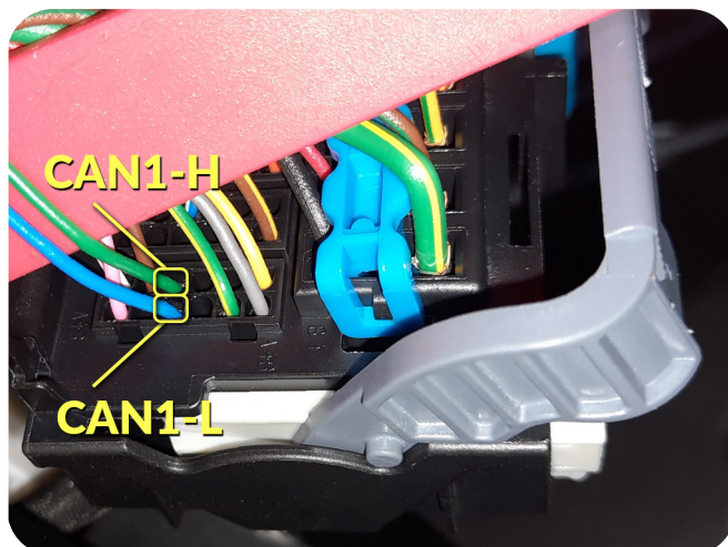
CAN1-H – зеленый провод, контакт № 39; CAN1-L – синий провод, контакт № 45.
